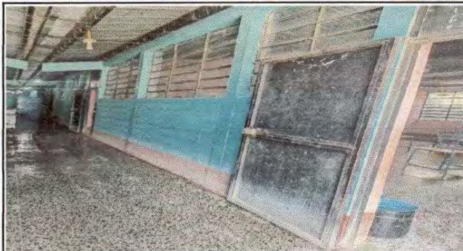
Foto1: PUERTAS DE METAL
